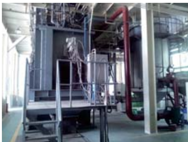
垃圾燃烧气化炉用上19系列电子尺
